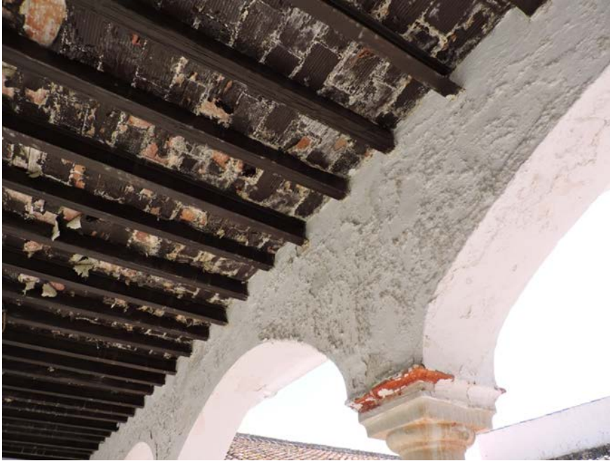
Detalle del deterioro que presenta el inmueble.
