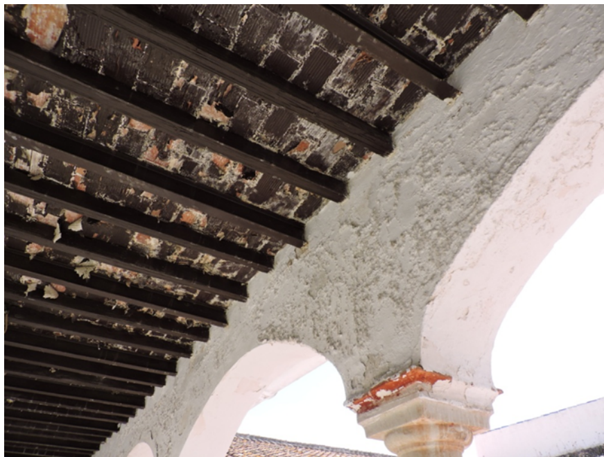
Detalle del deterioro que presenta el inmueble.
